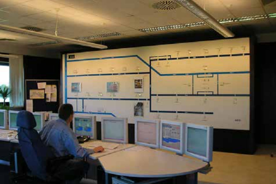
Fernsteuerzentrale Wasserversorgung Datteln. Foto: RIK/Budde
